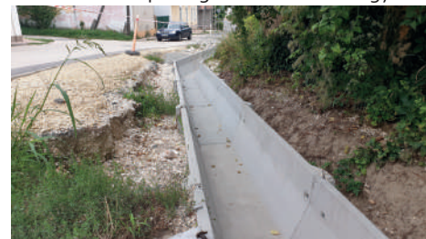
A betonvályút szegélyező vízmosás bizonyítja, hogy ez a keresztmetszet nem alkalmas a nagy esőzések során lezúduló vízmennyiség elvezetésére
