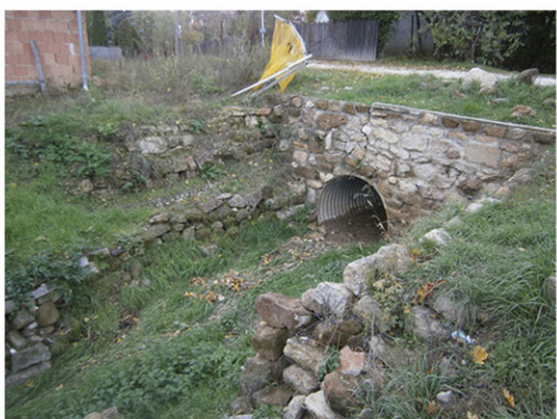
1. Kőhíd a Lovarda utca torkolatánál, omladozó mederburkolat
